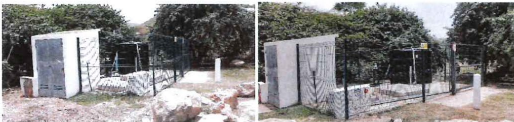
Poste de relevage actuel
