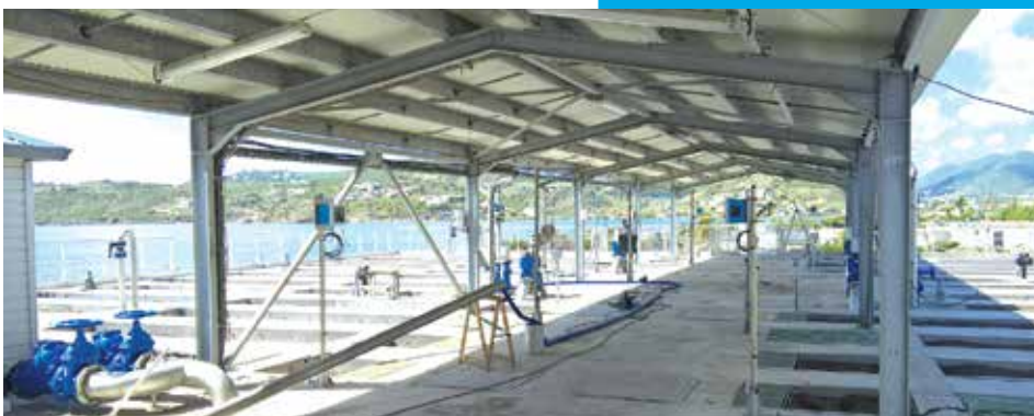
Un système moderne de traitement des eaux usées à Quartier d'Orléans
