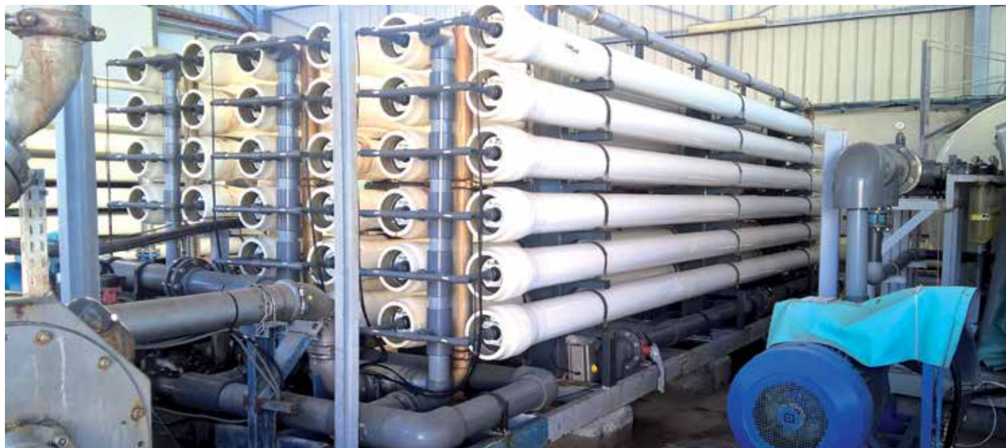
Le système de dessalement de l'eau par osmose inverse
